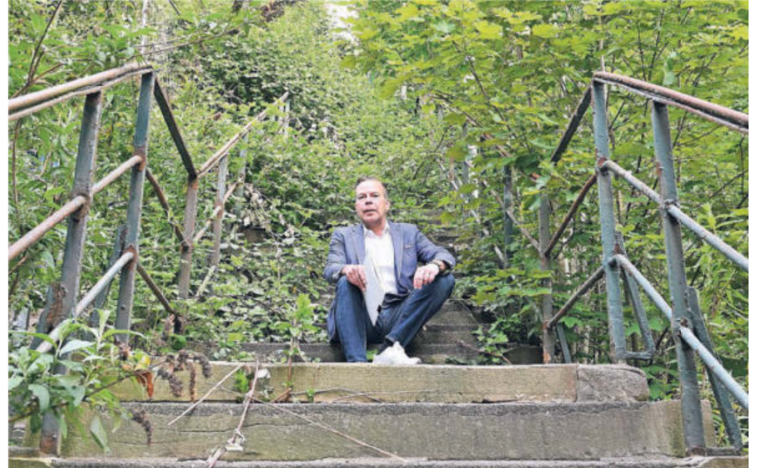
Marcus Kammel ärgert sich, dass die 1887 erbaute Jakobstreppe immer weiter verfällt.
