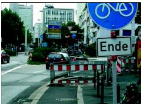
Radweg endet an der Baugrube, rechts zum Gehweg eine Kette, links die Fahrbahn: Baken auf der Fahrbahn als Einfädelhilfe würden helfen.
