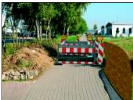
Bei Vollsperrung des Weges muss eine Umleitung ausgewiesen oder ein Ersatzweg befestigt werden.
