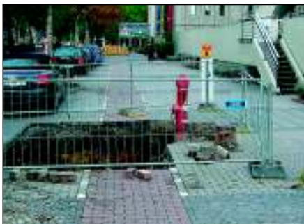
Falsch und gefährlich: Eine Baugrube, die nur mit einem Bauzaun gesichert ist, lässt sich ...
