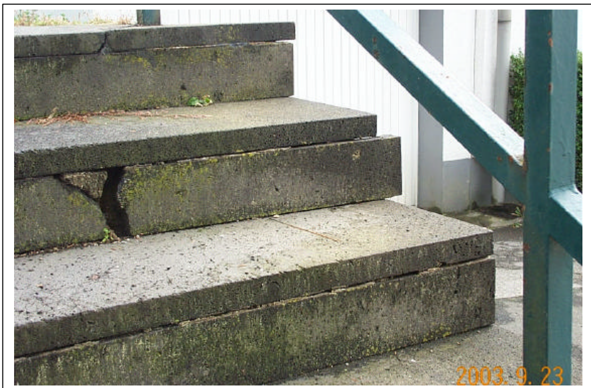
Foto 4 gebrochene und verschobene Betonplatte / Setzstufe
