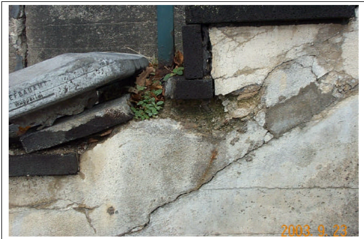
Foto 3 Ausbruchstelle am korrodierten Geländerfuß, gebrochene Betonplatte / Trittstufe
