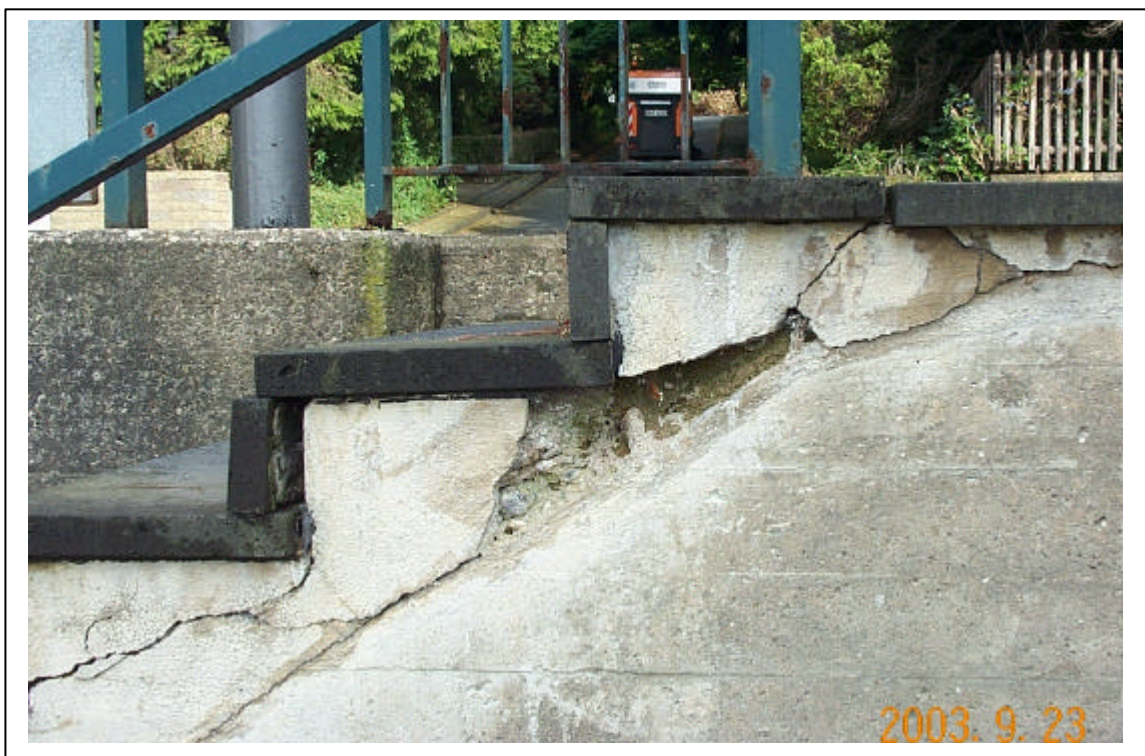
Foto 2 Ausbruchstelle mit verschobener Betonplatte im Trittstufenbereich
