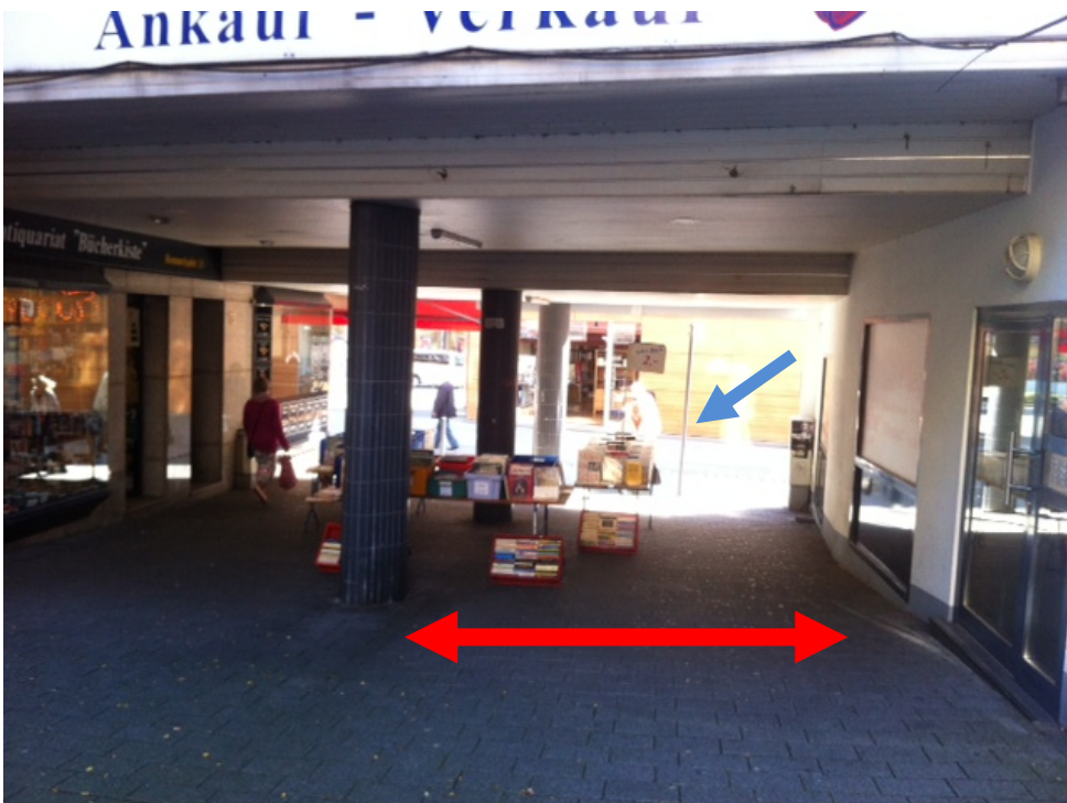
Blickrichtung von Westen nach Osten (Durchgangsbreite ca. 2,00m; Anordnung der Warenauslage muss optimiert werden, sodass eine Durchgangsbreite von mind. 2,50m zwischen Säule und rechter Hauswand erzielt wird)
