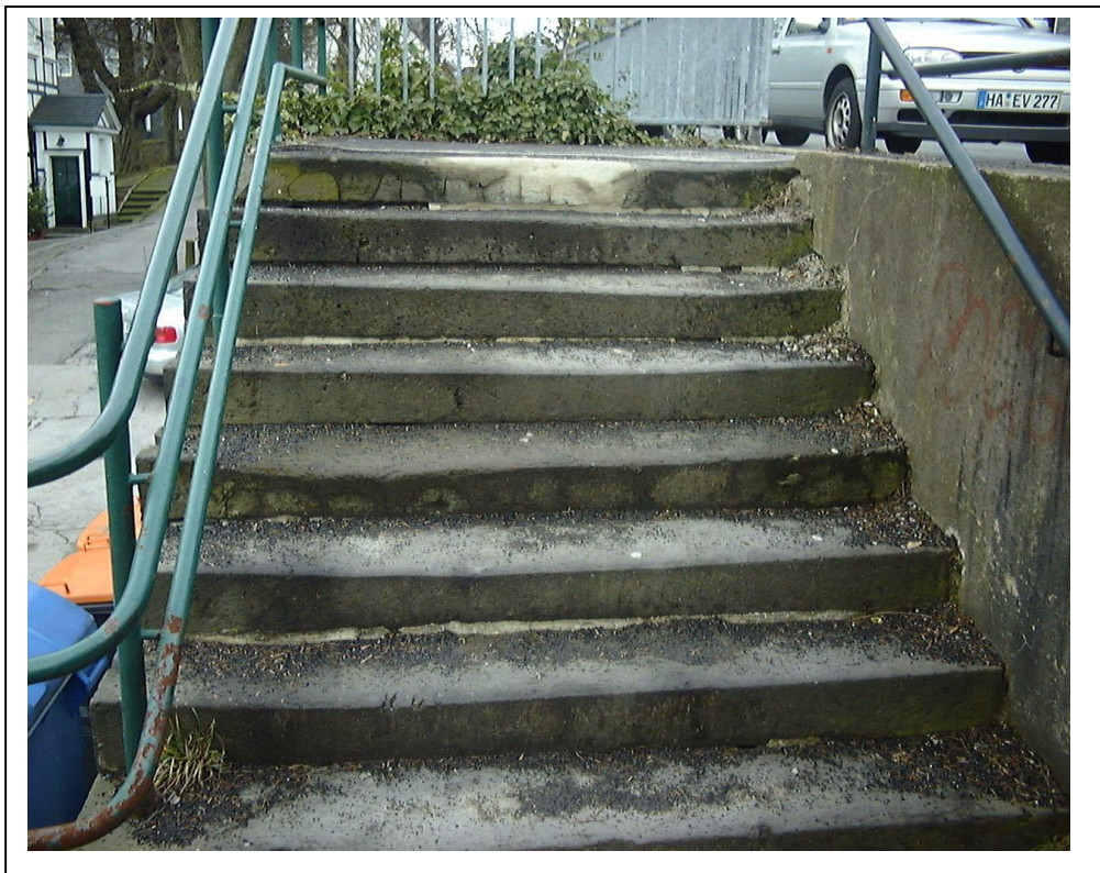
Foto 3: Stufenschäden am oberen Treppenlauf
