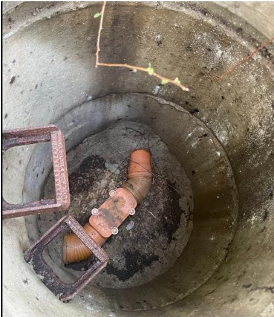
Abbildung 5 Anschlussstelle für den Schwarzwasserkanal am Wohnhaus
