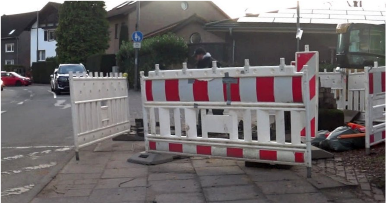
#6 Mehrfach muß verbotenerweise auf die Fahrbahn wegen diverser „Baustellen“-Blockaden ausgewichen werden. Baugruben liegen teilweise offen.
