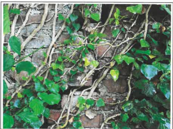
Bild 22: ... mit fingerdick offenen Fugen.
