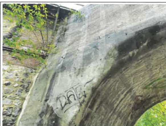
Bild 11: Sinterfahnen und Risse-Schäden in der Spritzbetonhaut im Bereich des Brückenbogens.
