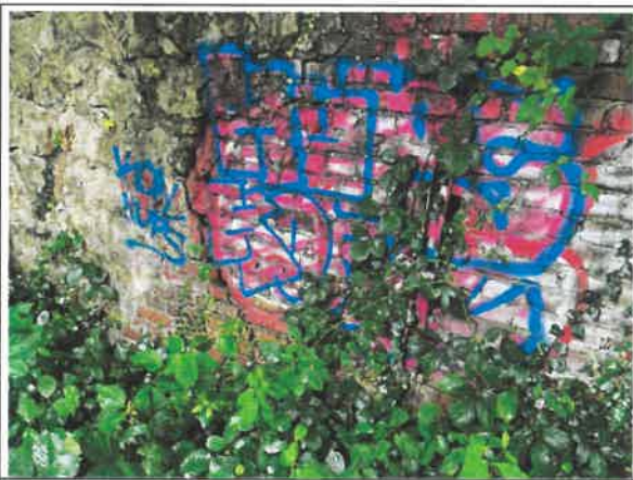
Bild 21: Efeubewuchs an der tlw. zerissenen Mauerschale ...
