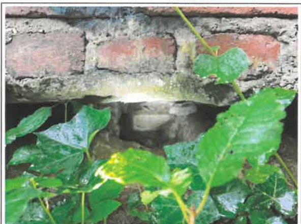
Bild 18: ... sich mehrere Dezimeter tief in das Bauwerk.
