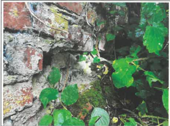
Bild 16: Ausbruch am Mauerfuß.
