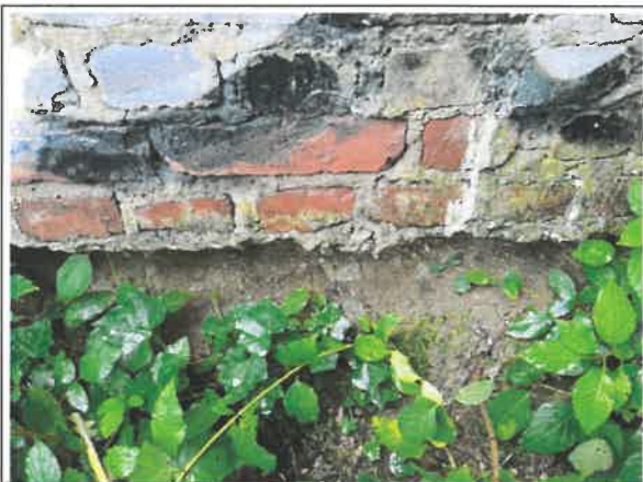
Bild 17: Unterhöhlte Mauerschale. Der Hohlraum erstreckt ...
