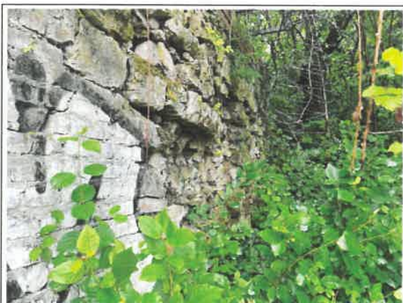
Bild 13: Ausbruchstelle in der Kalkstein-Verblendung und ...
