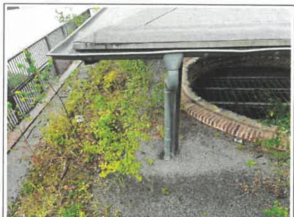
Bild 8: Im Splittuntergrund verschwindendes Fallrohr der Dachentwässerung.
