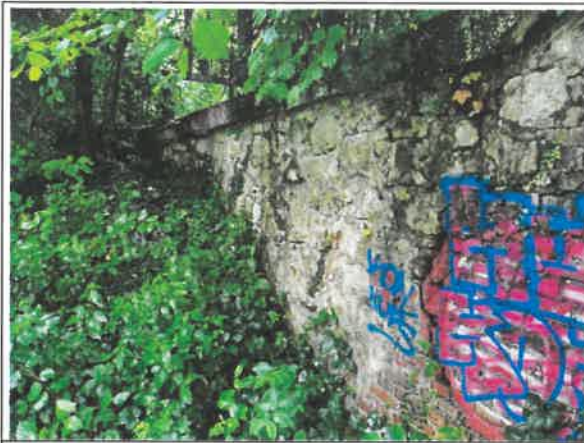
Bild 19: Mehr oder weniger intakte NSt-Verblendung mit altem Betonbalkenabschluss ...
