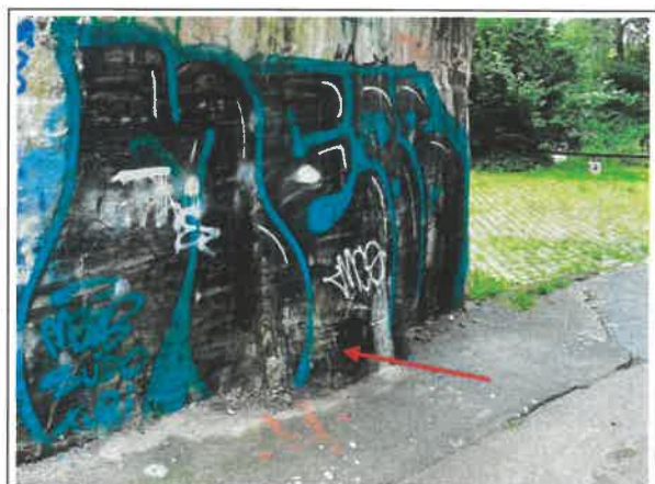
Bild 12: Die Funktion des in das Lichtraumprofil hineinkragenden Wulstes (s. Pfeil) ist unklar.
