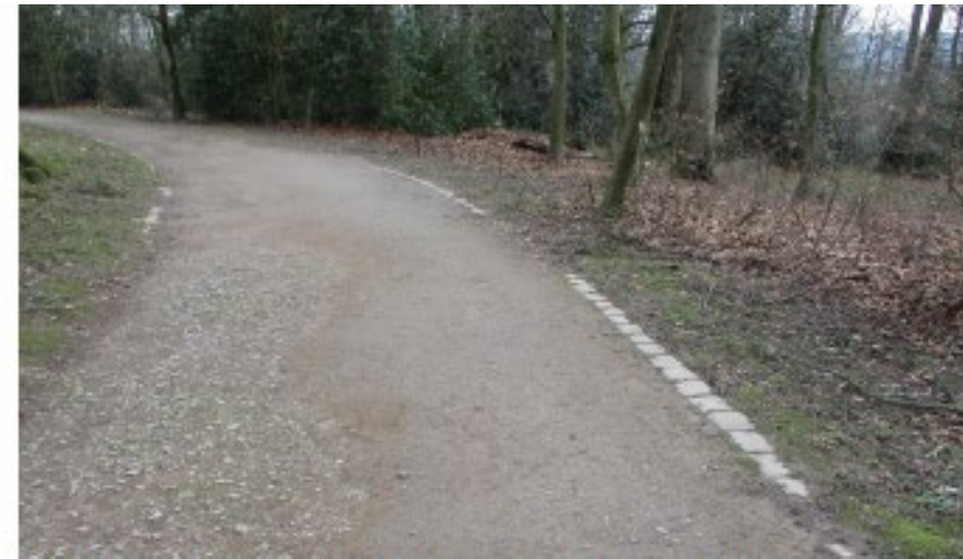
Wasserschaden wassergebundene Wegedecke
