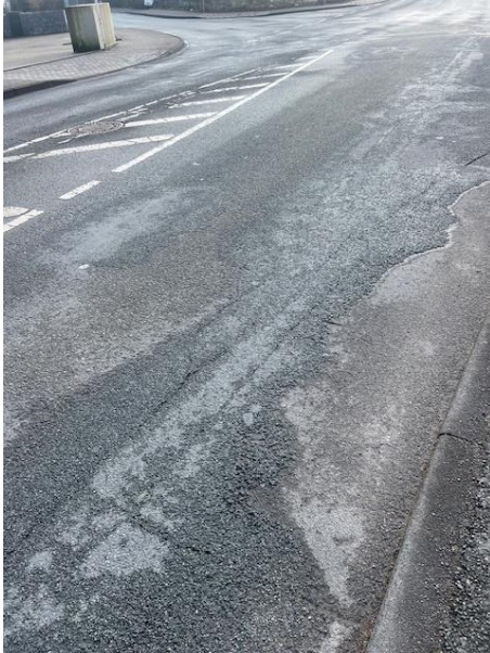
Foto 12: Risse sind deutlich zu erkennen
