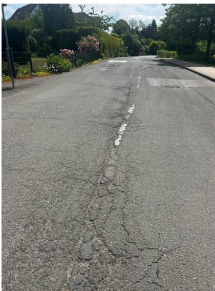
Foto 2: Risse / NetZRisse im Asphaltbelag
