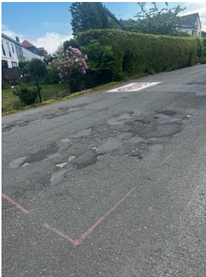
Foto 1: Fahrbahnschäden / geflickte und ausgebrochene Asphaltstellen
