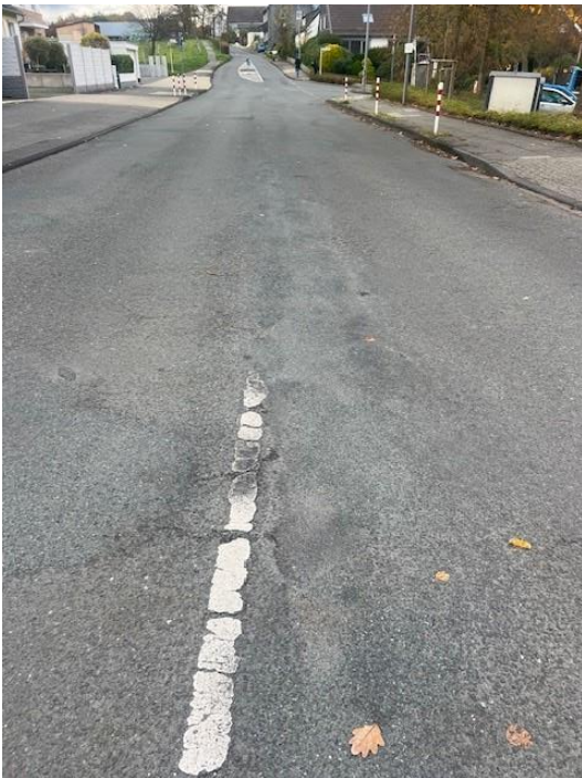
Foto 11: Es zeigen sich Verdrückungen / Unebenheiten in sanierten Bereichen
