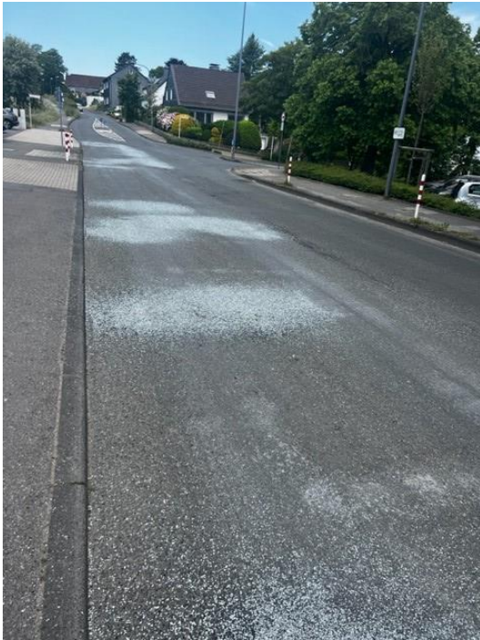
Foto 7: Ergebnis nach der Sanierung: erhöhtes Splittaufkommen
