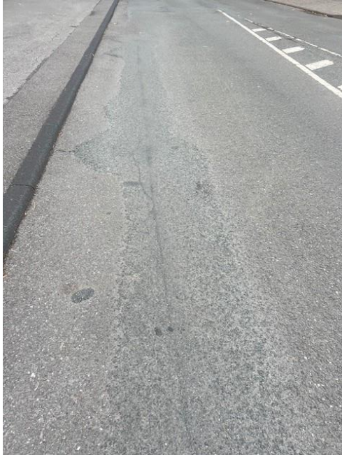
Foto 10: Risse im Belag zeigen sich in sanierten Bereichen
