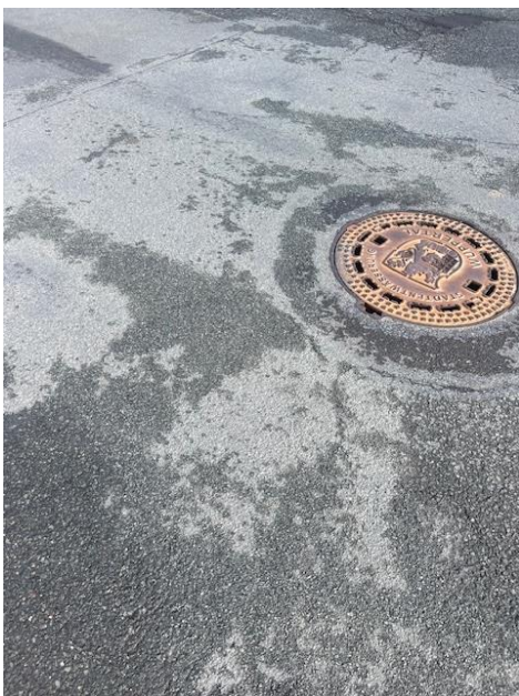
Foto 13: Material- und Kornverlust sind auffällig
