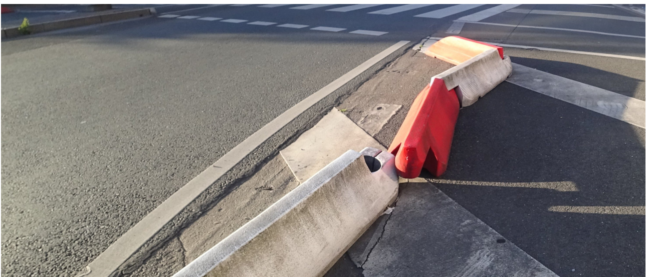
Abb. 4: defekte Leitborde vor drei Tagen (20. Juni 22).
