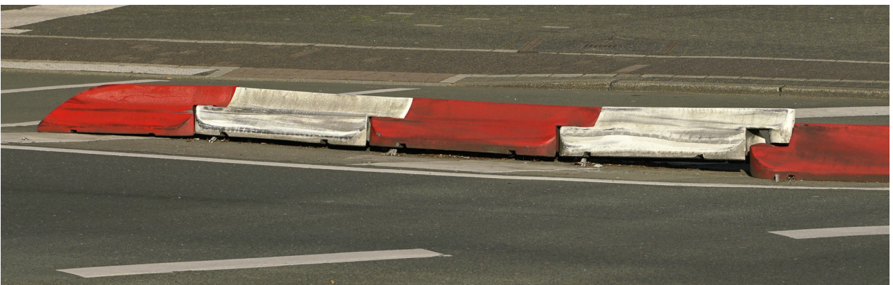
Bild 8: defekte Leitborde Ende April 2022
