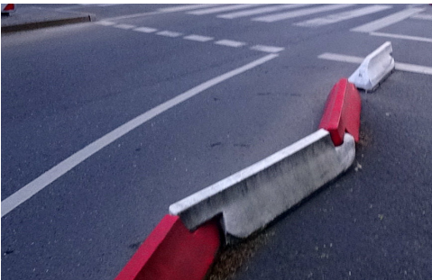
Bild 9: defekte Leitborde Anfang Mai 2022
