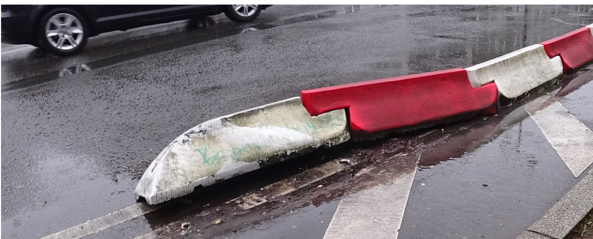
Bild 4: defekte Leitborde März 2020
