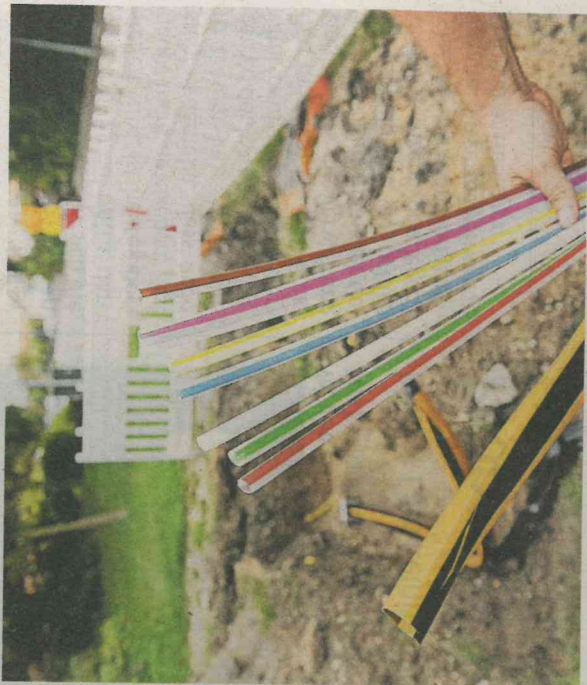
Leerrohre für Glasfaserleitungen für schnelles Internet.
