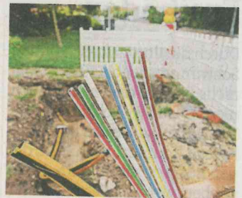
Der Ausbau des Breitbands wird zu bis zu 10 000 Einzelbaustellen in Wuppertal führen. Symbolfoto: dpa
