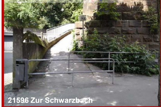
Hindernisse im Lichtraumprofil
